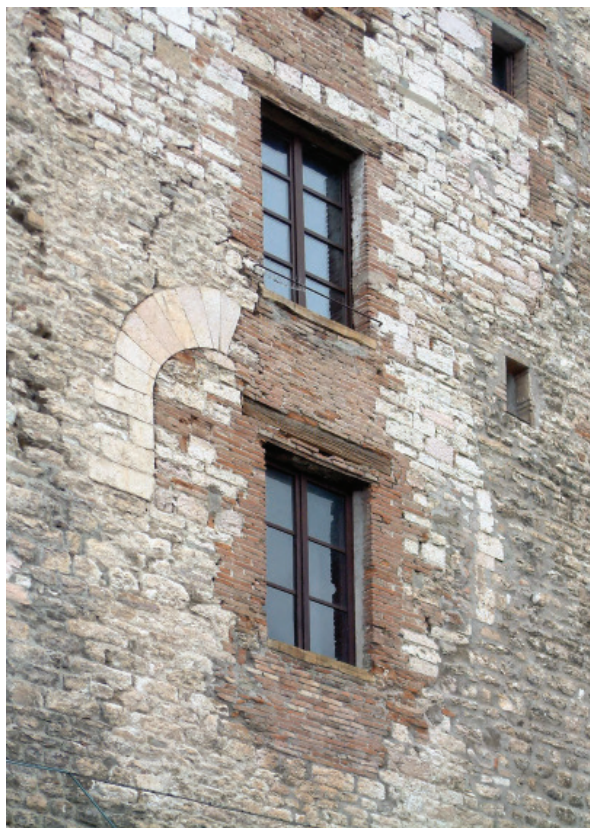
Figura 5. Relaciones estratigráficas corta / cortado por, rellena / rellenado por, se adosa / se le adosa. Edificio en Gubbio (Italia). Fotografía: C. Mileto y F. Vegas.
