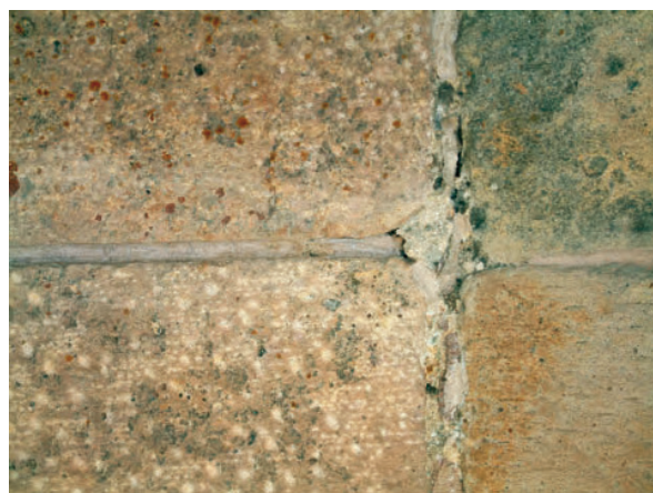
Figura 10. El mortero de la intervención se adosa al mortero antiguo rellenando las lagunas. Campanario de la Iglesia Parroquial de Vistabella del Maestrazgo (Castellón). Fotografía: C. Mileto y F. Vegas.
