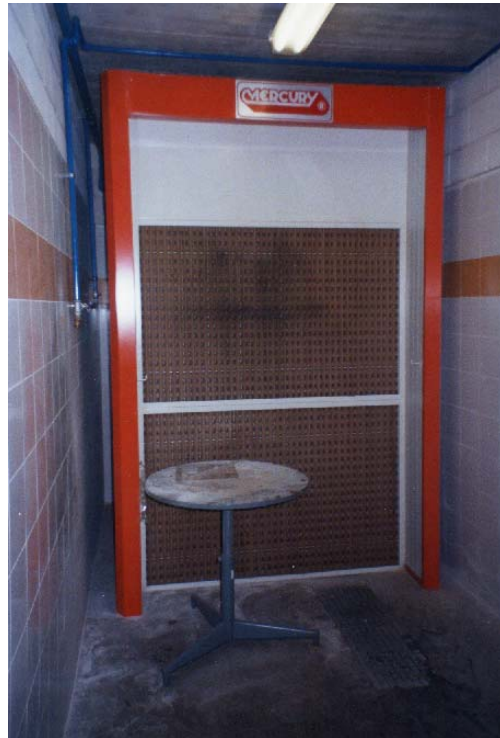
Figura 6. Cabina de pintura
